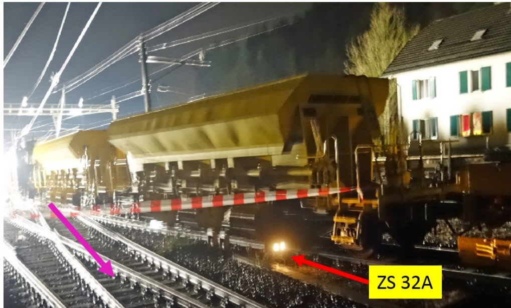
Abbildung 5: Abgestellte Wagen 1 und 2 ragen über das Zwergsignal 32A hinaus gegen die Zugfahrstrasse des Dampfzuges; lila Pfeil: Fahrstrasse Zug 30162.
