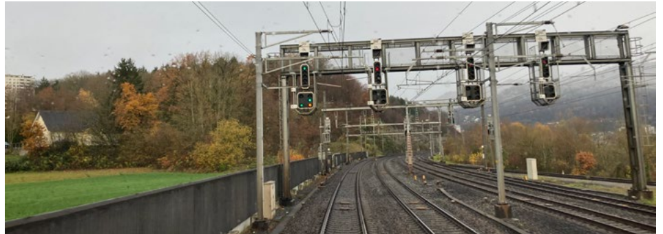
Segnale d'entrata, il segnale avanzato indica 90 km/h dalla sezione d'entrata.
